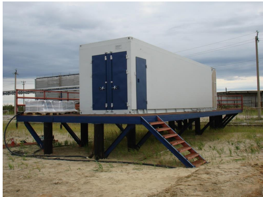
МЦОД «Датериум-3-Север» Газпромнефть-Ноябрьскнефтегаз (филиал Муравленковскнефть) 2012 г.
